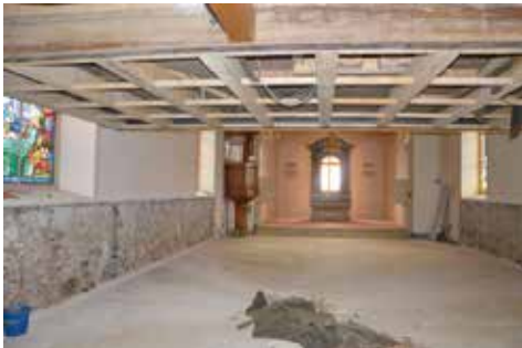
Die Bauarbeiten haben nach Ostern begonnen. Die Wiedereinweihung findet am 16. Oktober 2016 statt.
